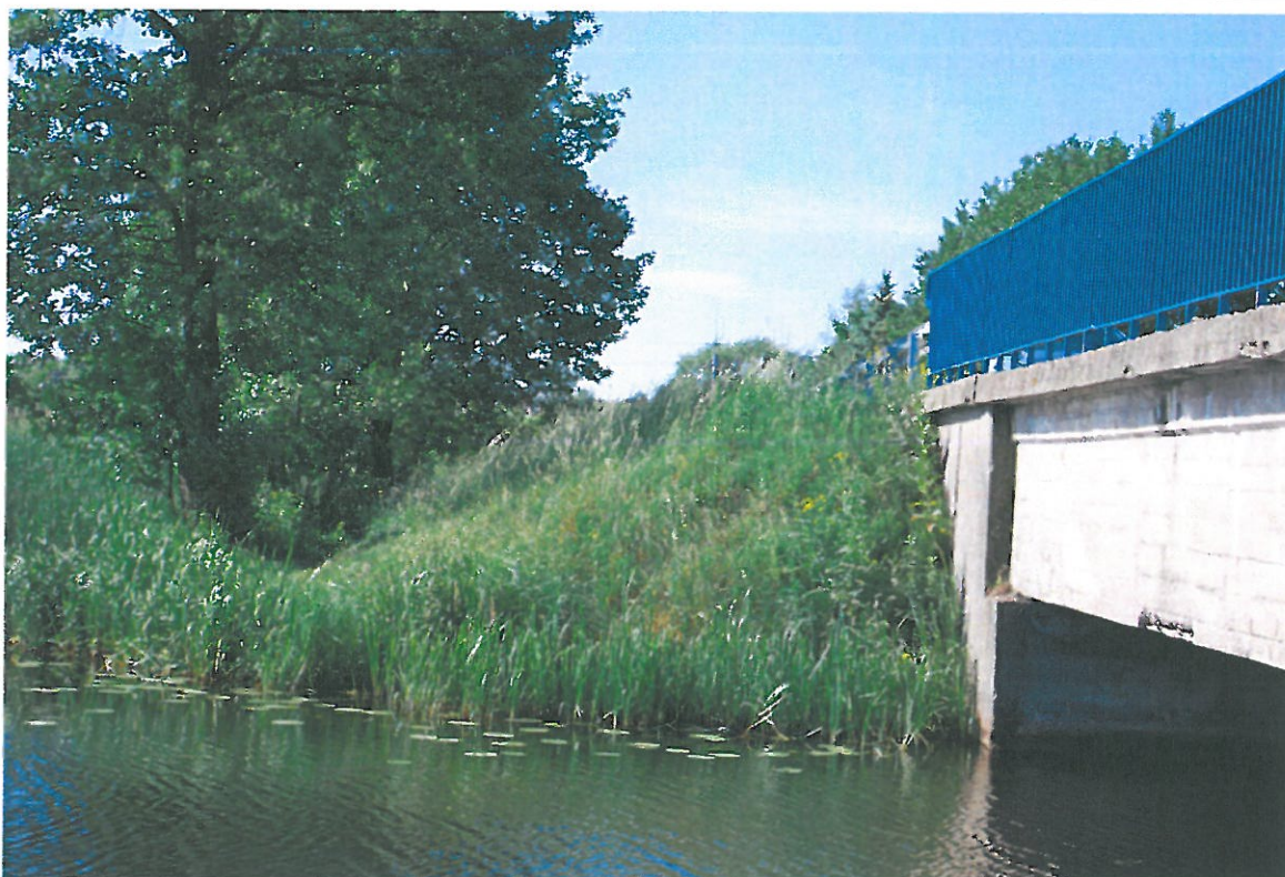
Fot. 5. Wegetacja roślin pogarszająca estetykę spowodowana brakiem systematycznych prac utrzymaniowych (stożek od strony południowej – widok od strony górnej wody)
