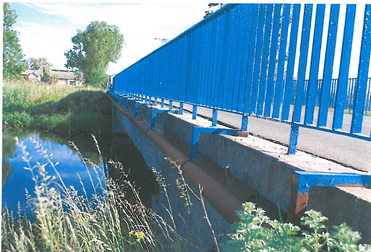
Fot. 17. Deformacja i korozja rury osłonowej.
