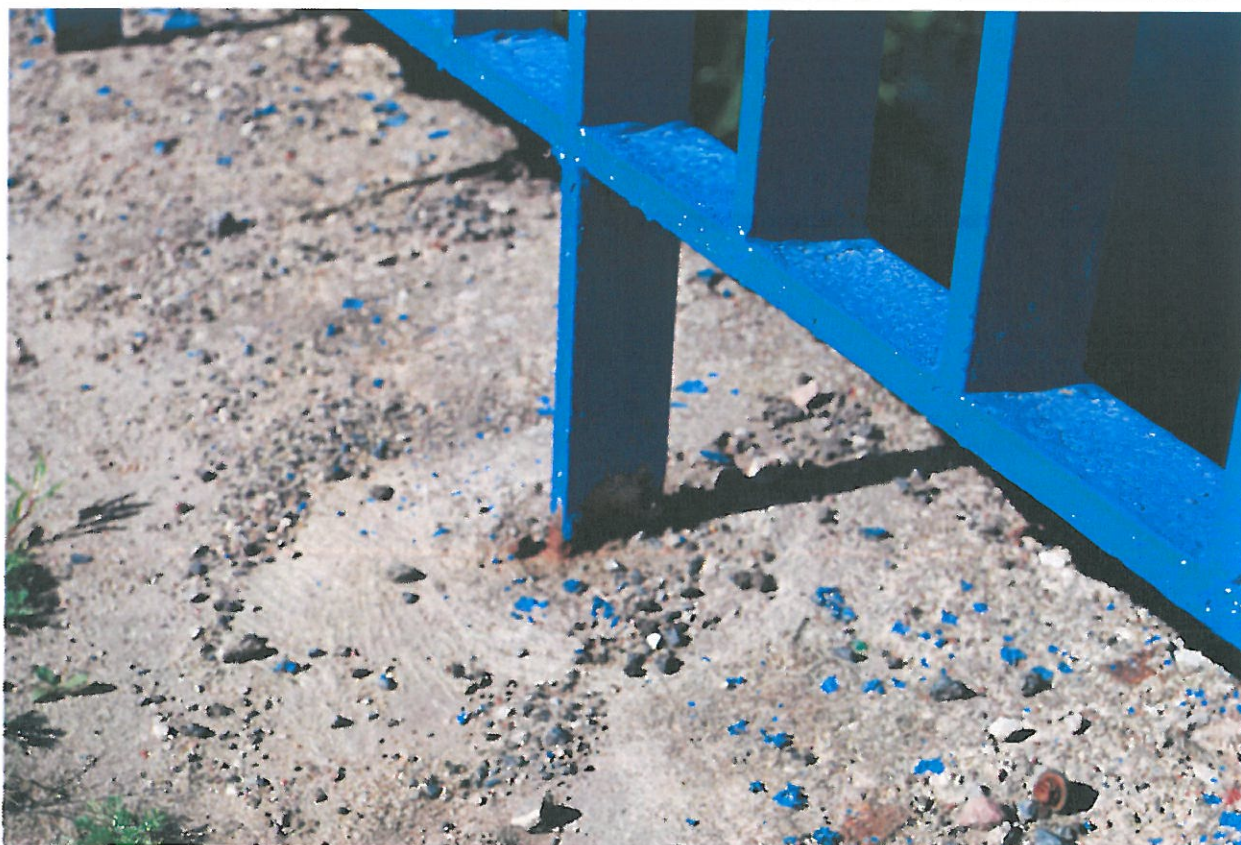
Fot. 10. Korozja słupka balustrady spowodowana niedokładnym pokryciem powłoką malarską.
