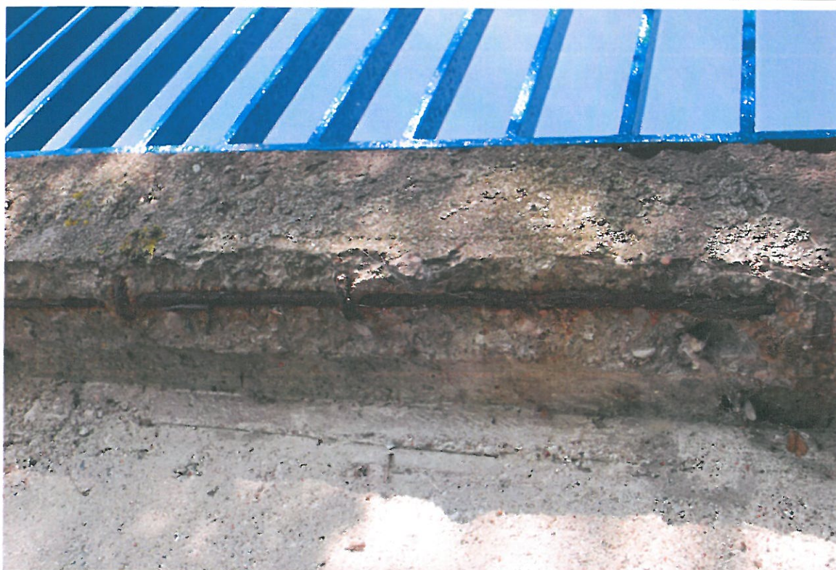
Fot. 12. Ubytki betonu i korozja stali zbrojeniowej belki podporęczowej od strony górnej wody.
