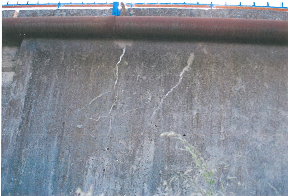
Fot. 16. Zarysowania skrzydełka przyczółka południowego – od strony dolnej wody.
