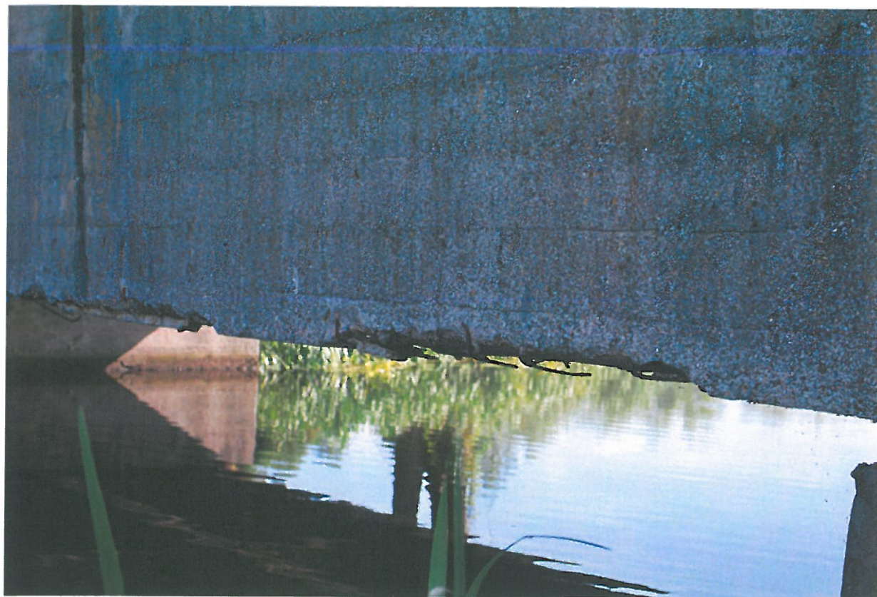
Fot. 13. Ubytki betonu i korozja stali zbrojeniowej dźwigara skrajnego – widok od strony dolnej wody
