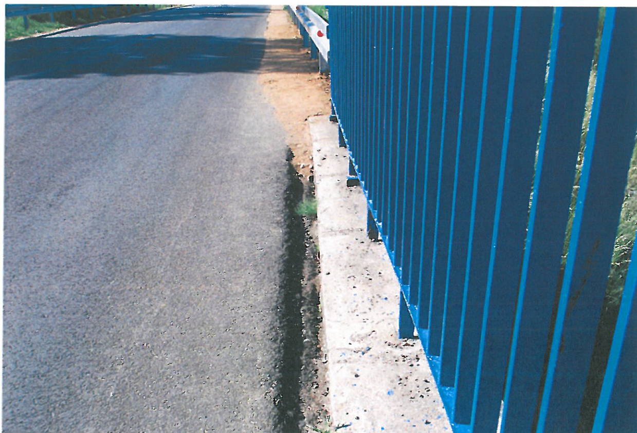
Fot. 8. Ubytki nawierzchni jezdni na dojeździe od strony południowej - widok od strony dolnej wody
