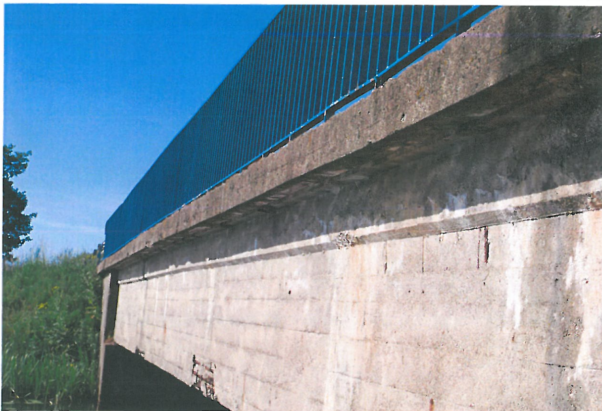
Fot. 11. Wykwity, osady i ubytki betonu na belce podporęczowej (widok od strony górnej wody)
