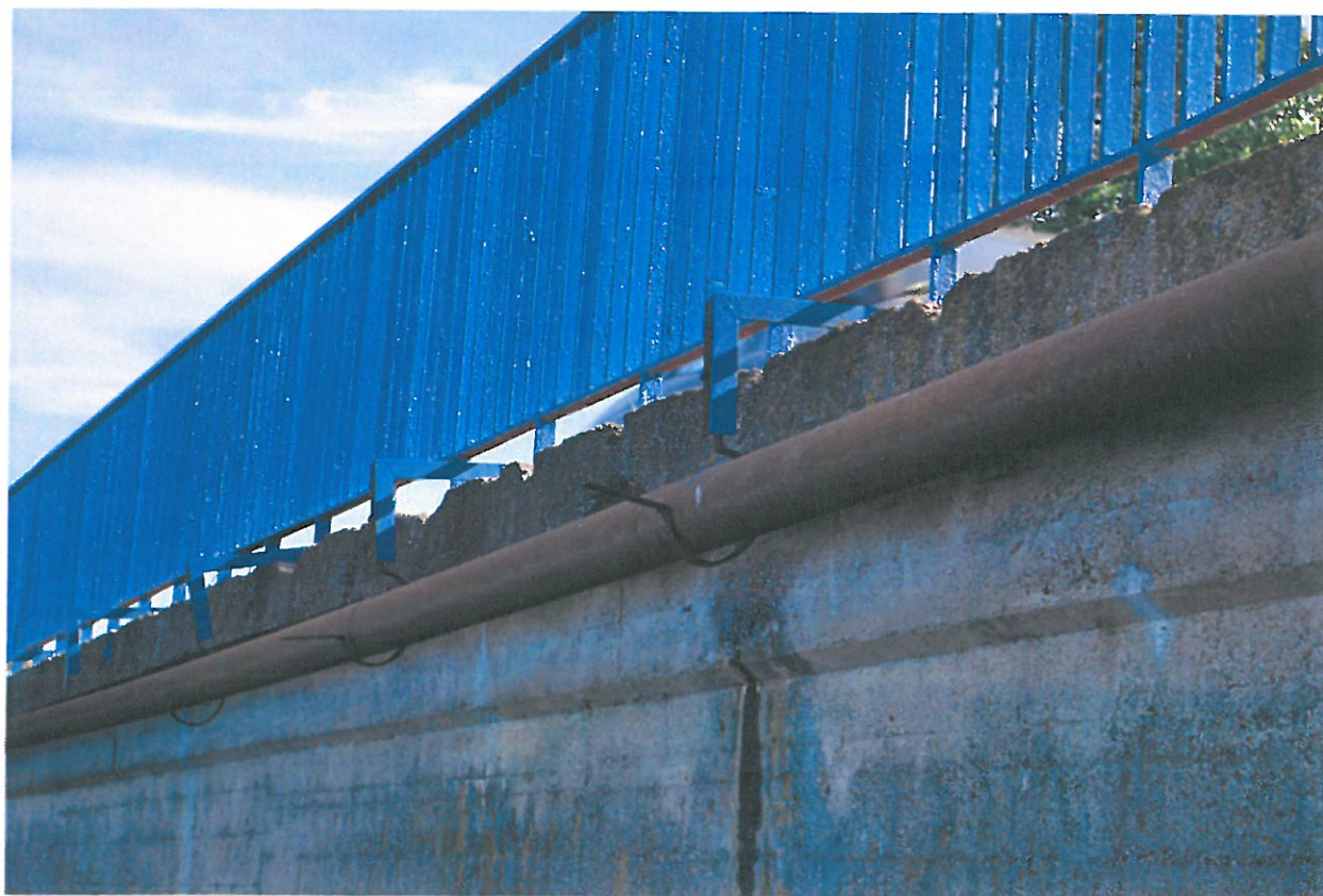
Fot. 18. Niekompletność elementów podwieszenia rury osłonowej.
