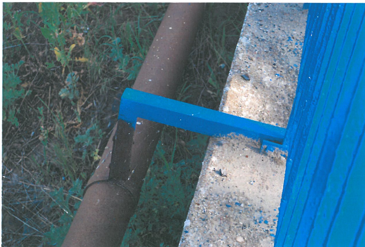
Fot. 20. Niedokładnie wykonanie zabezpieczenia antykorozyjnego elementu podwieszenia rury osłonowej.
